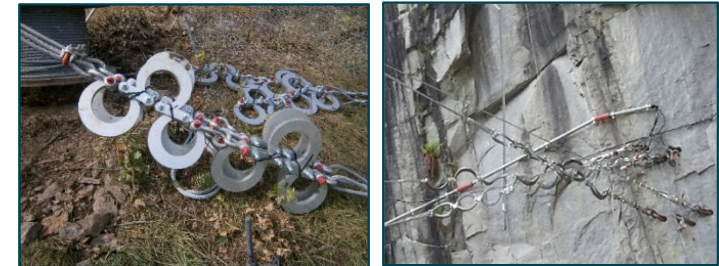
Dissipatori di energia
