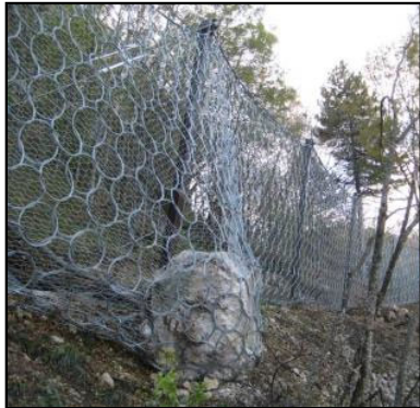
Struttura di intercettazione (rete)
